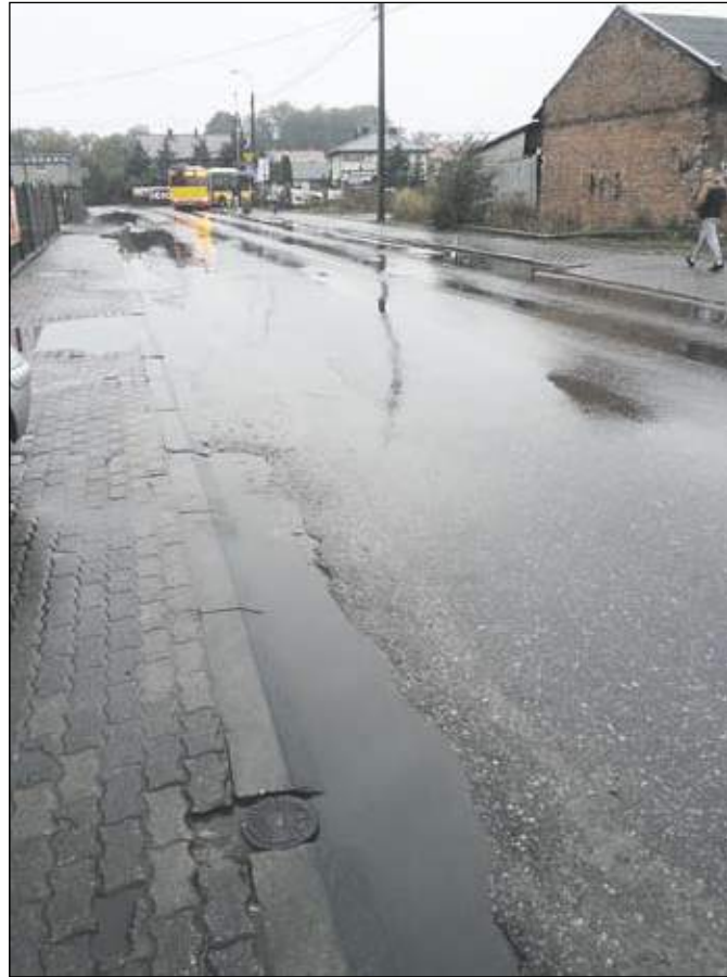
Ul. Lewandów jest przykładem braku planowania. W przyszłym roku zostanie dziurawy niespełna kilometr tej drogi.
