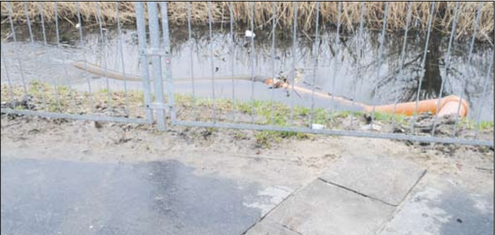
Aby poprowadzić rurę, wykonawca zniszczył miejski chodnik.
