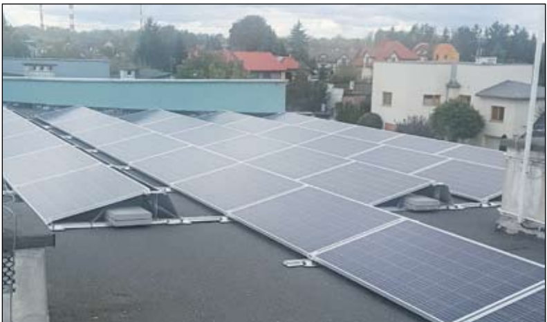
Panele słoneczne instalacji fotowoltaicznej na SP nr 109 przy ul. Przygodnej w Wawrze.
