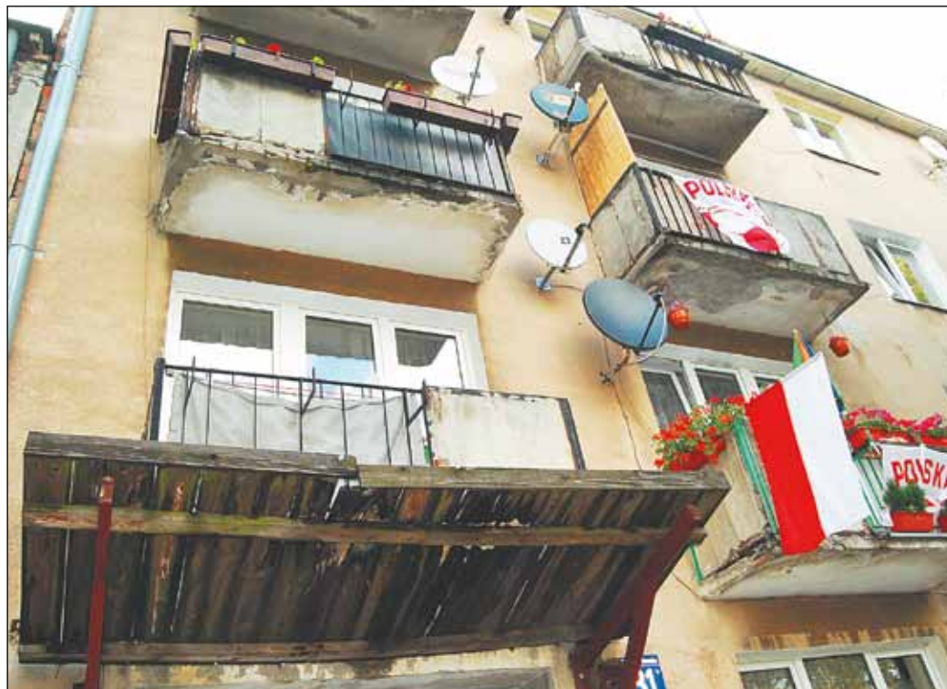
Zbutwiałe zabezpieczenia balkonów przy Kamionkowskiej 31 straszyły także w czasie EURO 2012.
