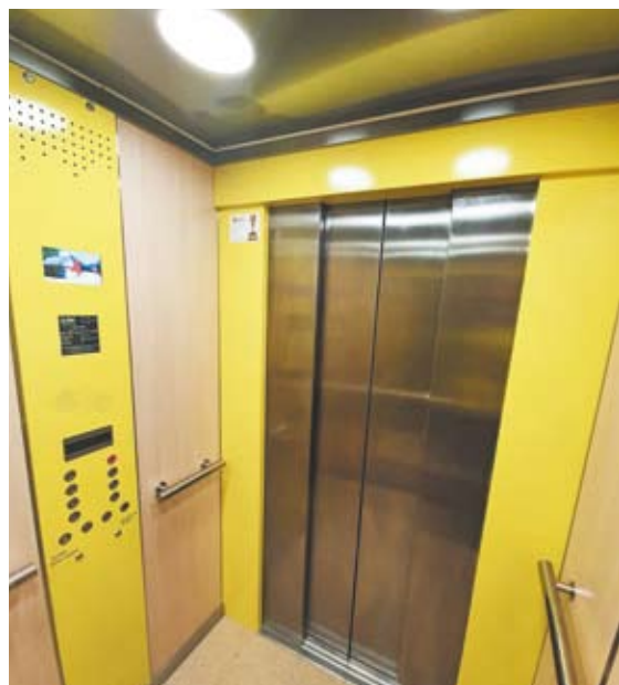
Zgodna z zasadami dobrych praktyk kabina w Głównym Urzędzie Statystycznym, Winda – Warszawa Sp. z o.o.
